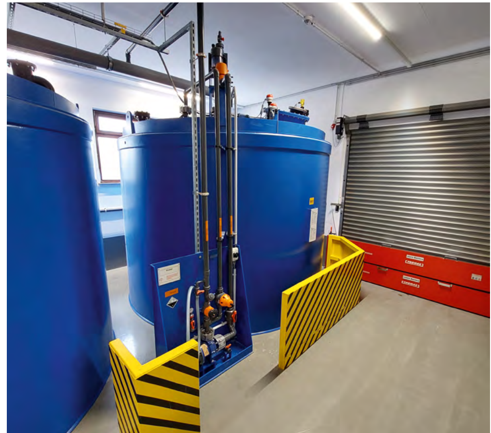
Am Standort Grebenau nutzen wir großvolumige Tanks für die Lagerung der Grundstoffe für unsere Waschchemie.
